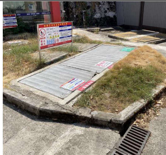
现有三级隔油池
